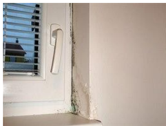
Poškození vnitřního ostění okna
