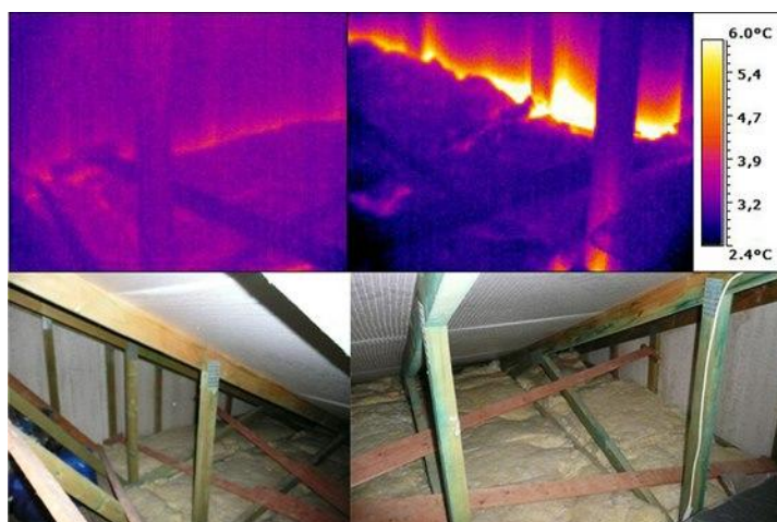
Termografické snímky z půdy. Vlevo rozdíl v těsnosti parotěsné vrstvy a vpravo chybějící tepelné izolace v napojení na stěnu.
