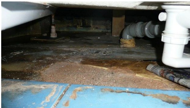
Pohled pod vanu s poškozenými vrstvami izolace. Noviny majitelé použili jako jednoduchý indikátor změn vlhkosti. | foto: Bytecheck
