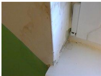
Vlhkost a nedostatečná izolace ostění poškodily vnitřní konstrukci.
